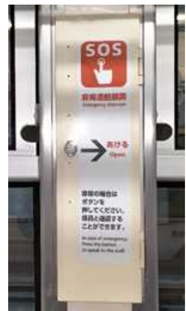
▲ 車内の「非常通話装置」
