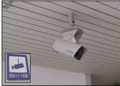
▲ 防犯カメラの設置
